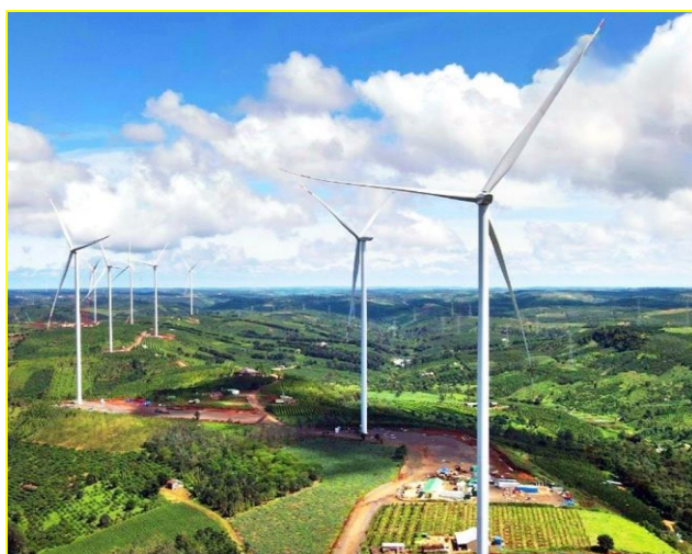
Hình 2.7. Nhà máy điện gió Đắk Song, tỉnh Đắk Nông (Nguồn: Báo Đắk Nông)
