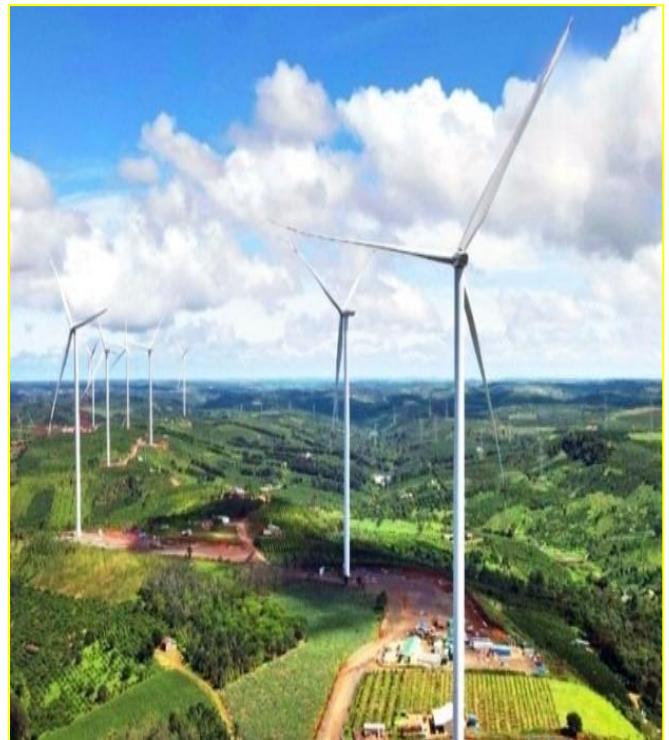
Hình 6.12. Nhà máy điện gió Đắk Song (Nguồn: baodaknong.vn)
